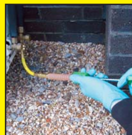
Fluoreszenz-Farbstoff wird der Anlage zugesetzt.
