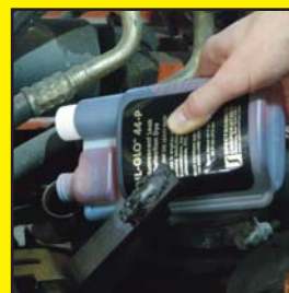
Fluoreszenz-Farbstoff wird der Anlage zugesetzt.
